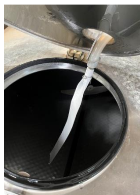
進儲乳槽的管路末端
