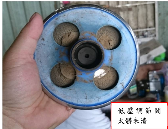
低壓調節閥久未清理，作動異常
