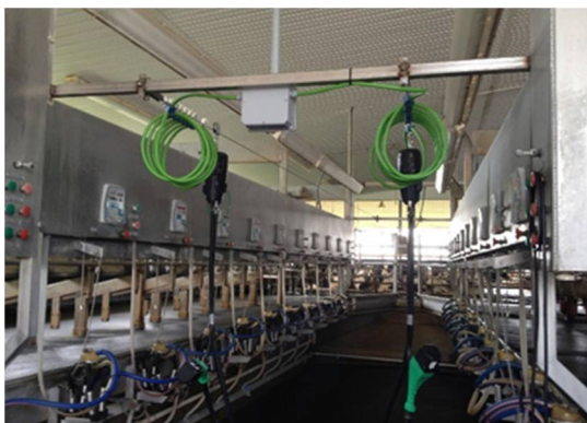
圖三、安裝乳頭清洗刷的榨乳室
